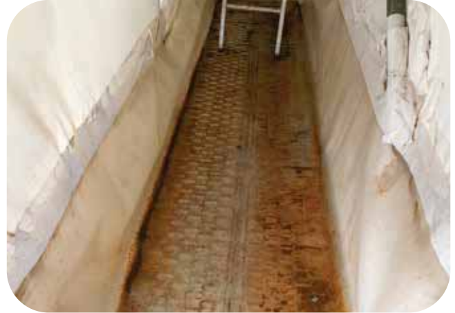
Foto después de la inauguración
